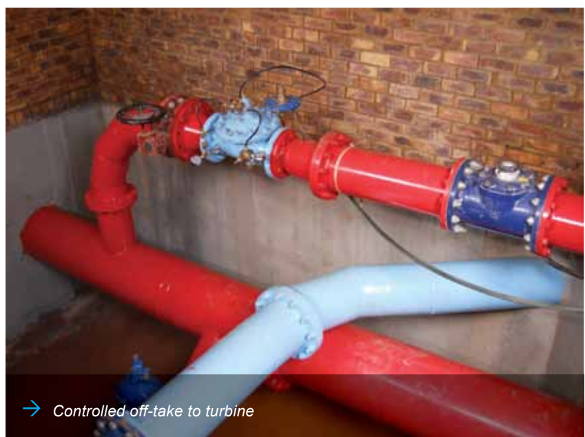
→ Pierre van Ryneveld conduit hydropower plant
