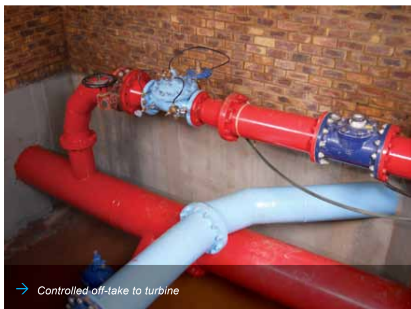
→ Pierre van Ryneveld conduit hydropower plant
